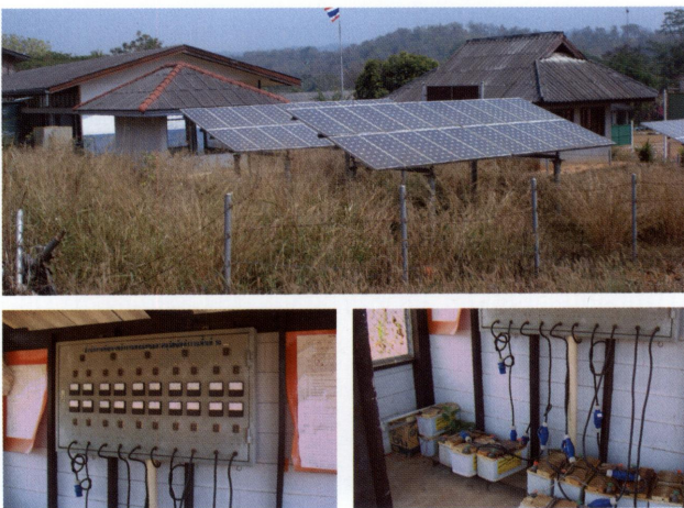
รูปที่ 3.1 ระบบผลิตไฟฟ้าประจุแบตเตอรี่ด้วยเซลล์แสงอาทิตย์ สำหรับหมู่บ้านชนบทที่ไม่มีไฟฟ้า
