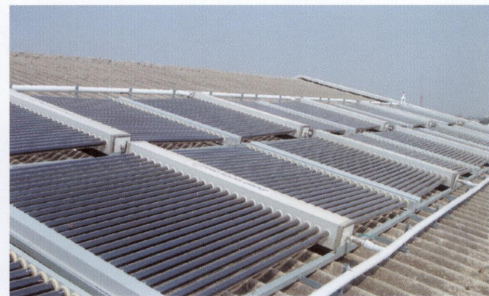
รูปที่ 3.26 ระบบผลิตน้ำร้อนพลังงานแสงอาทิตย์ โรงพยาบาลพุทธชินราช จ.พิษณุโลก
