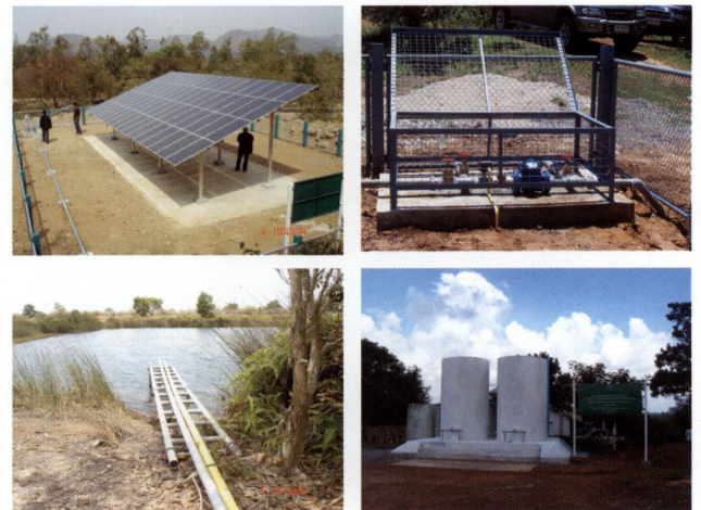
รูปที่ 3.3 ระบบสูบน้ำพลังงานแสงอาทิตย์และถังเก็บน้ำ จังหวัดมุกดาหาร
