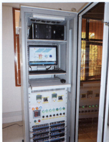
รูปที่ 3.21 ระบบควบคุมและแสดงผล
