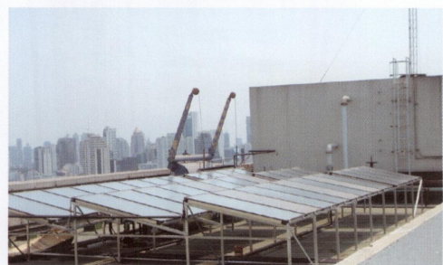
รูปที่ 3.28 ระบบผลิตน้ำร้อนพลังงานแสงอาทิตย์ โรงแรมรอยัล ออคิดเซอร์ราตันไฮเทล แอนด์ ทราเวอร์
