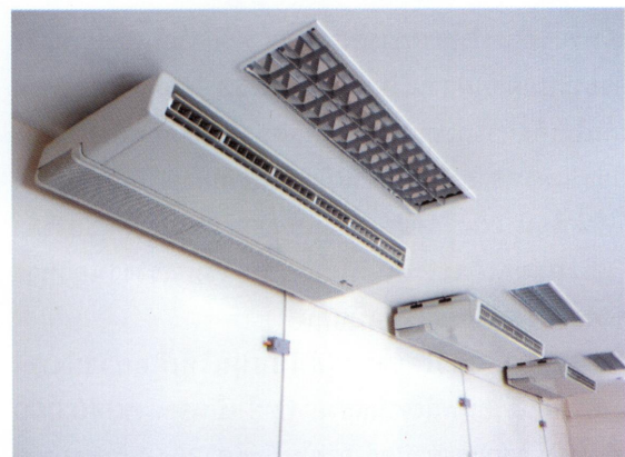
รูปที่ 3.22 ระบบปรับอากาศ
