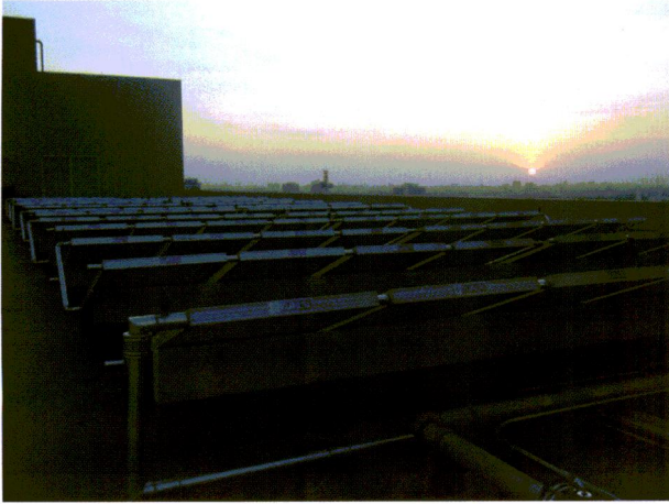
รูปที่ 5.6 แผงรับรังสีดวงอาทิตย์ระบบผลิตน้ำร้อน พลังงานแสงอาทิตย์ โรงพยาบาลศูนย์วิจัยศึกษา โรคมะเร็ง สถาบันวิจัยจุฬาภรณ์
