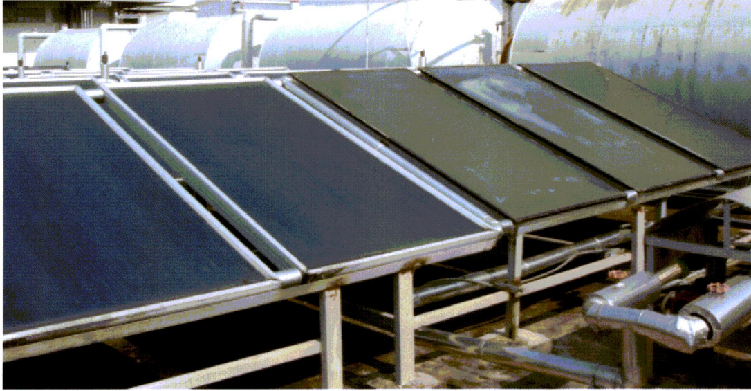
รูปที่ 5.3 ระบบผลิตน้ำร้อนพลังงานแสงอาทิตย์ โรงแรมดุสิต โฮสเทลด์ รีสอร์ท
